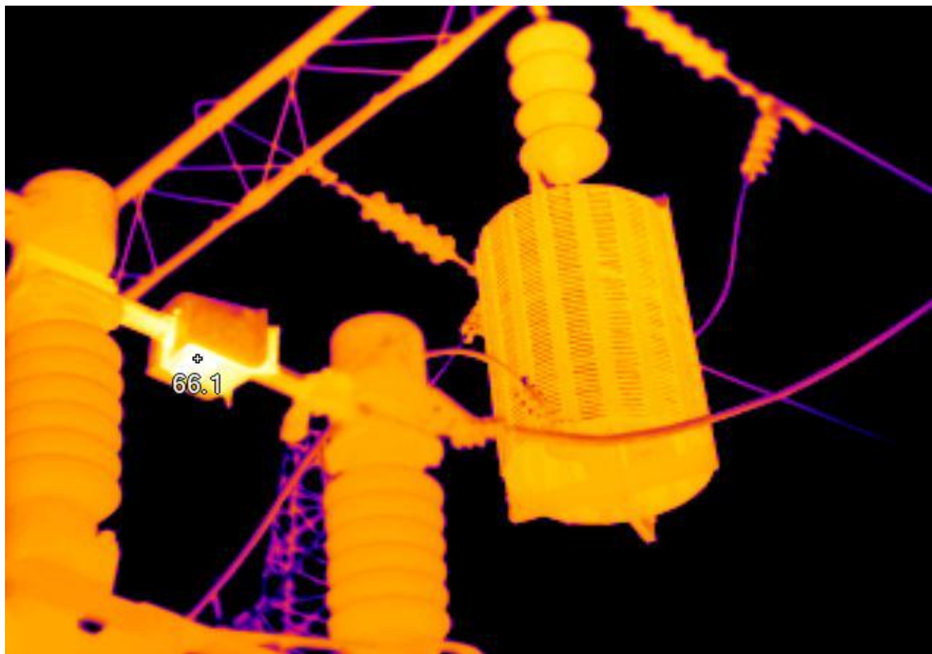
中间触头压指弹簧压接不良
